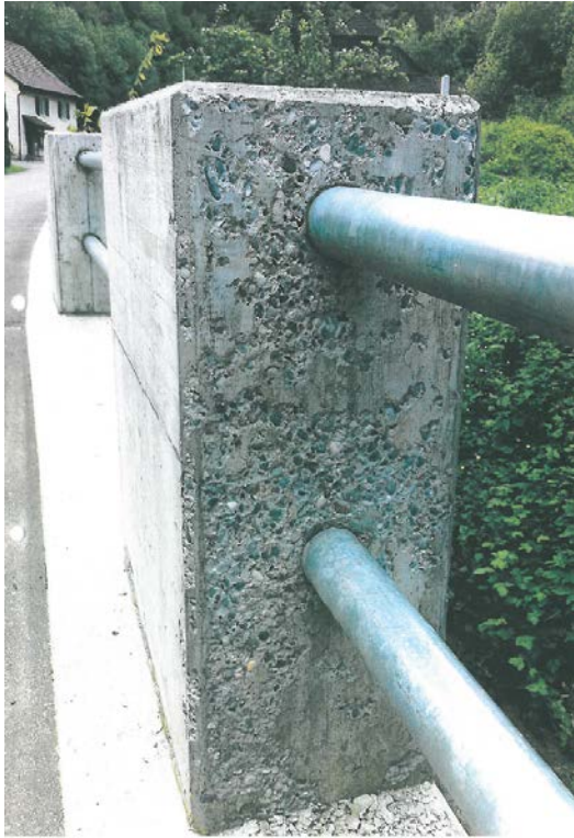
Abb. 34 Rasche und starke Schädigung durch Frost- und Frosttaumittelinwirkung auf einen für diesen Einsatz ungeeigneten Beton (Beton für die Expositionsklasse XC 2 mit einem w/z-Wert von 0.65). Foto: A. Mongillo Stampbach SA, Delémont.
