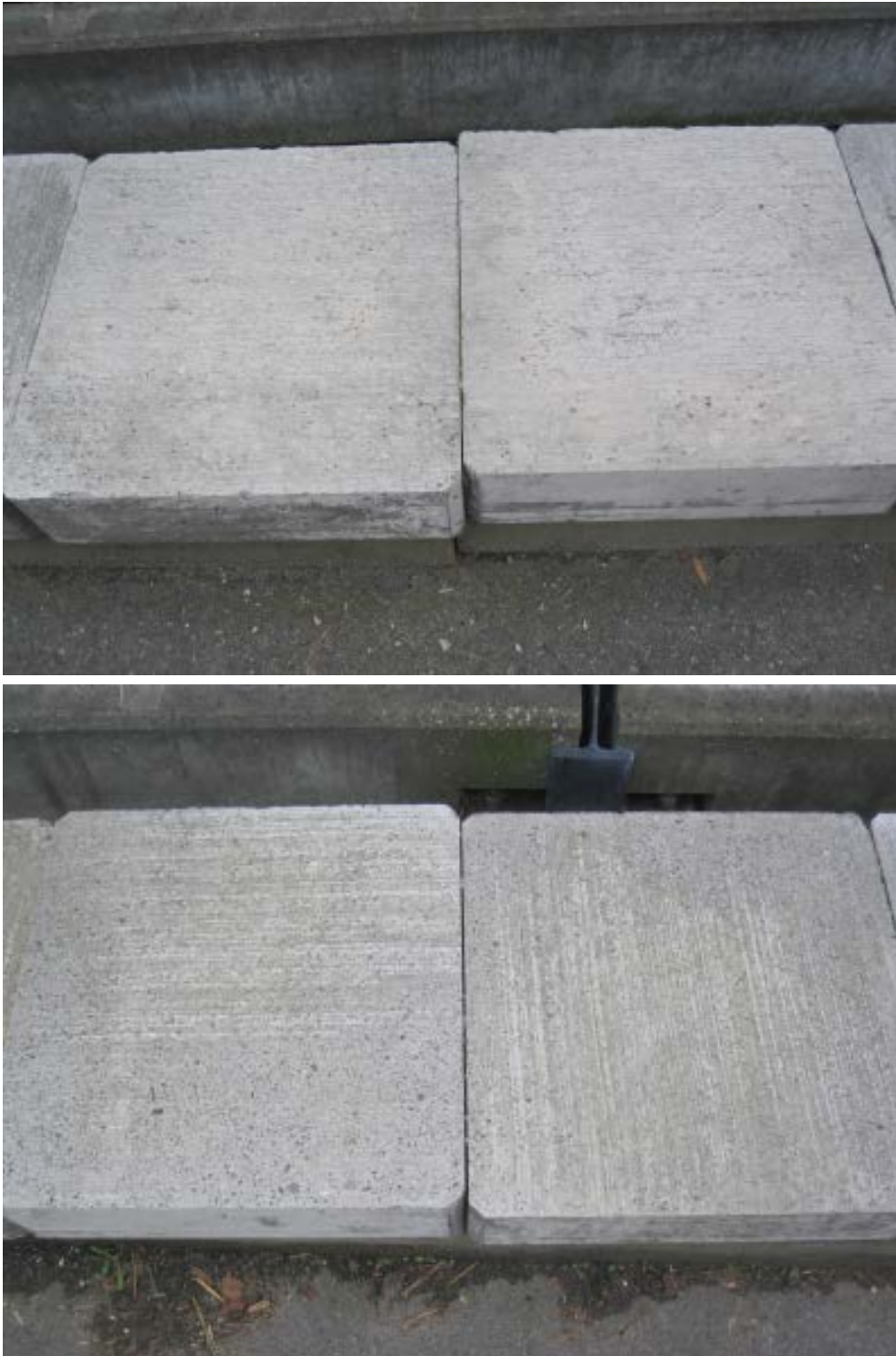
Abb. 17 Zustand der Versuchsplatten am 18.10.2013. Oben: Beton 3. Unten: Beton 8.
